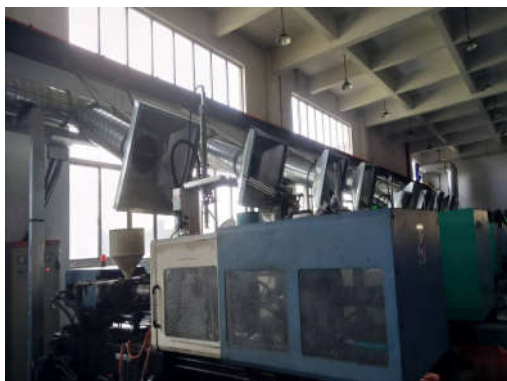
车间整体密闭换风
