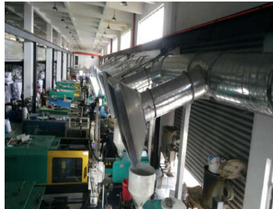
废气集气罩及管路
