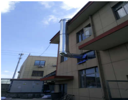
15m 高排气筒
